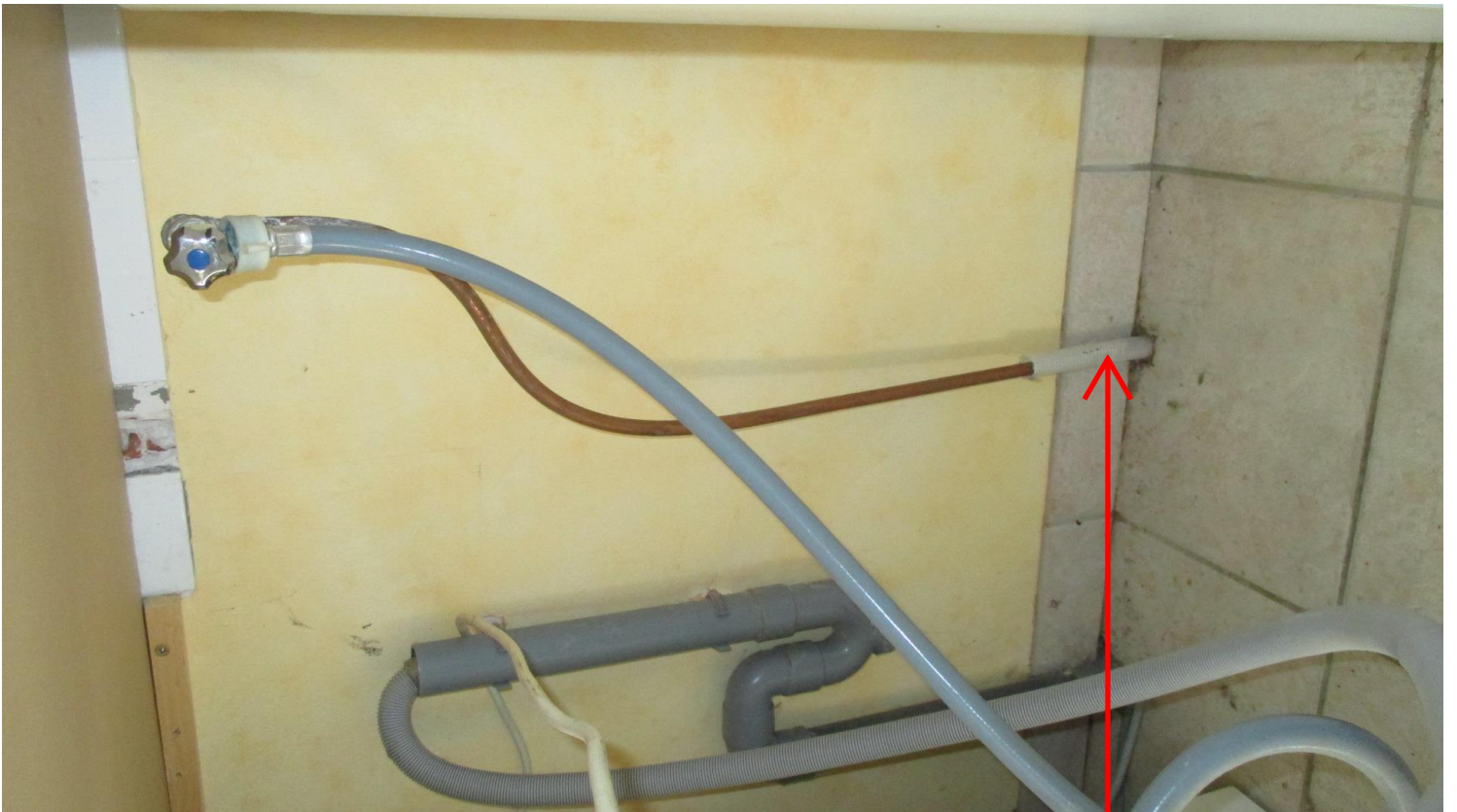
Canalisation d'arrivé de la fuite
